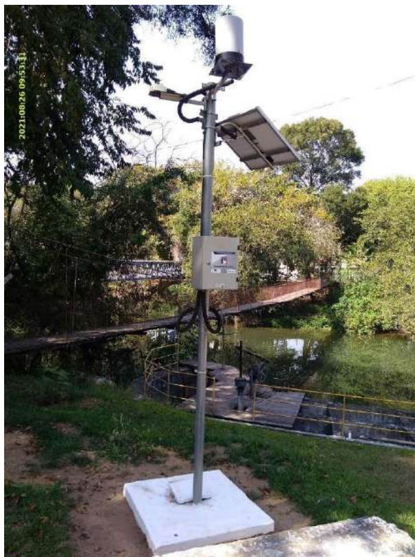
Estação Telemétrica Limpa (longe)
