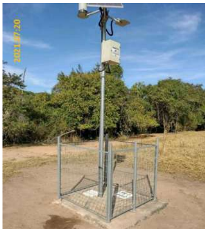
Foto 5 – Estação Hidrométrica Automática no PHM (Data: 20/07/2021).
