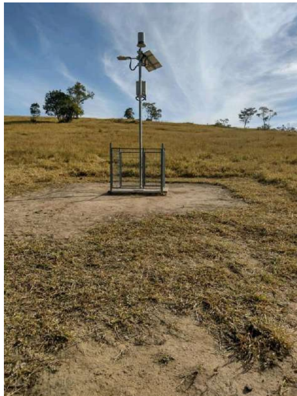
Estação Telemétrica Limpa (longe)
