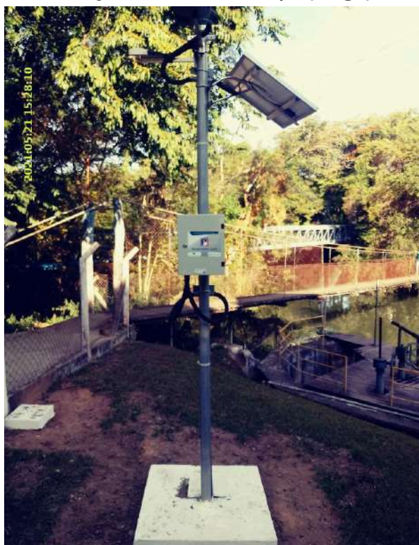
Estação Telemétrica Limpa (longe)
