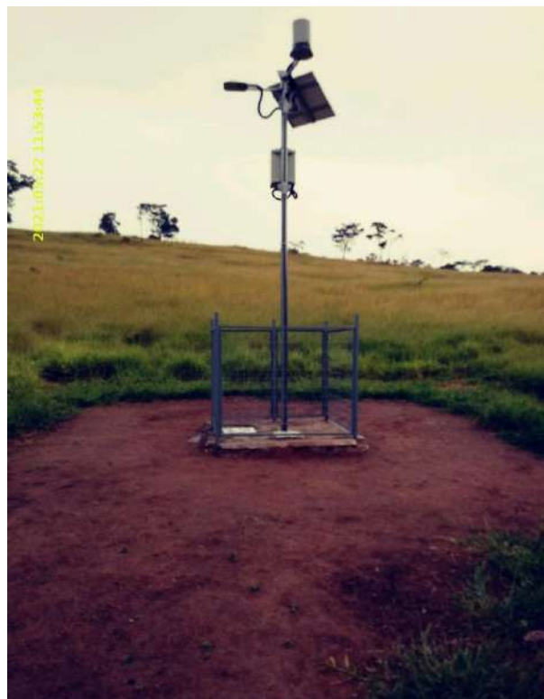
Estação Telemétrica Limpa (longe)
