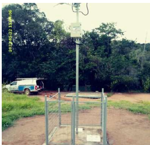
Foto 1 – Estação Hidrométrica Automática no PHM (Data: 22/05/2021).
