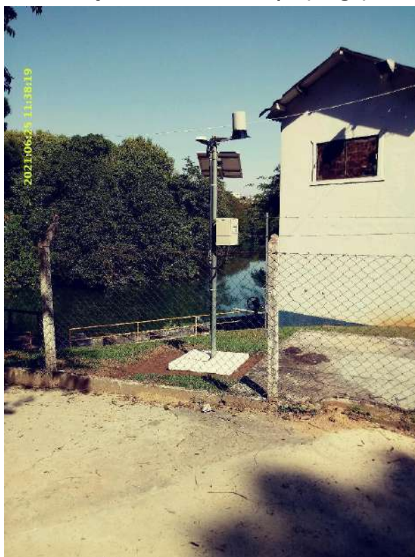
Estação Telemétrica Limpa (longe)
